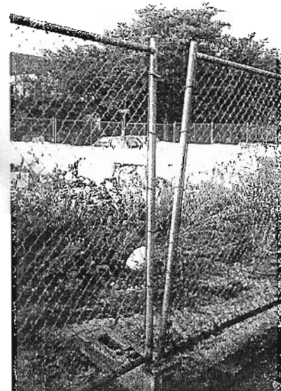
Hek werk is niet gekoppeld, onbevoegden kunnen gemakkelijk de bouwplaats betreden.
